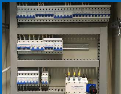
Жилой комплекс. ВРУ1 Компания ООО «Бонпет»
