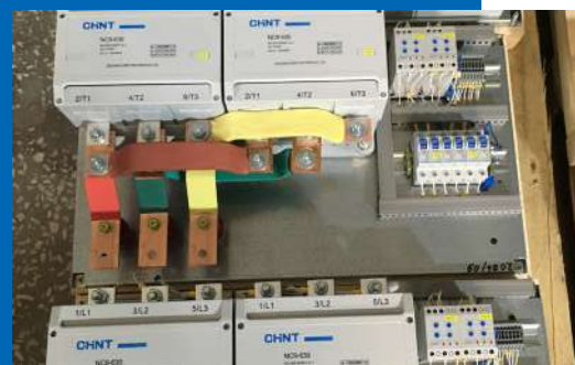
Устройство АВР на 630А, г. Крым
