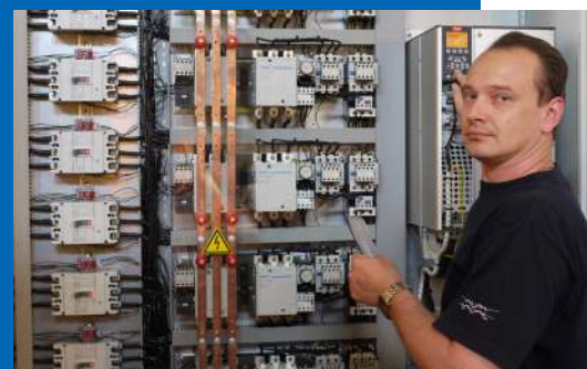
Система управления насосами повышения давления. ООО "ЭТК «Бортек»
