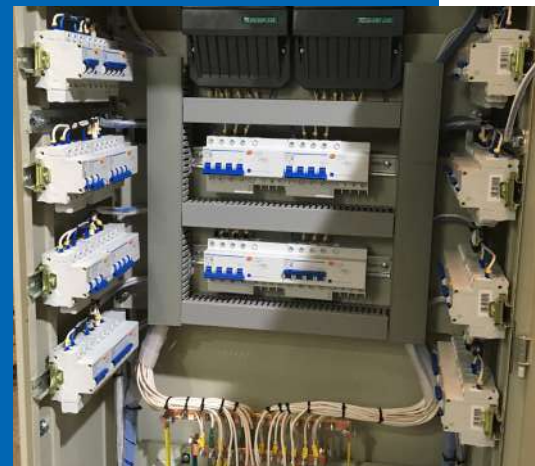
ГРЩ с АВР для административно-бытового комплекса «Роснефть» Компания ООО «Бонпет»
