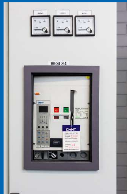
Вводное распределительное устройство ООО «Автоматика водоснабжения»
