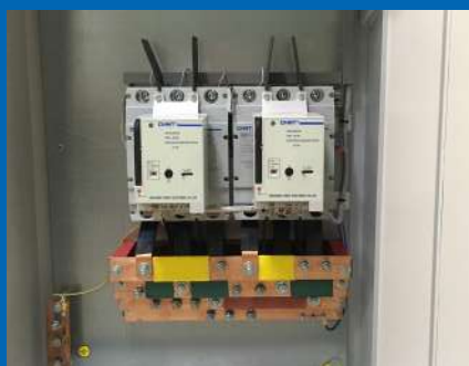
ЗАО Лонмади, Зеленоград, АВР 800А на 2 ввода для генератора JCB Компания ООО «Бонпет»
