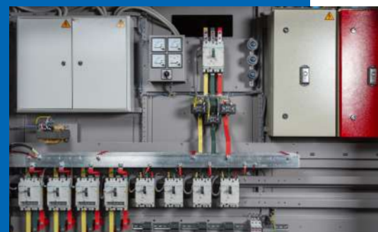
Киосковая ТП 400кВА. Компания «Блосс Инжиниринг»
