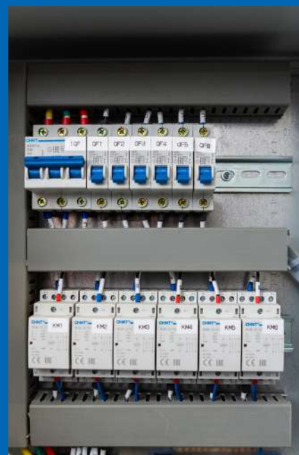
Щаф управления освещением ООО «Автоматика водоснабжения»
