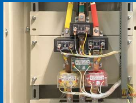
Жилой комплекс. ВРУ2 Компания ООО «Бонпет»
