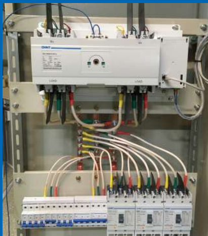
ГРЩ 315А с АВР. Гостиничный комплекс Компания ООО «Бонпет»
