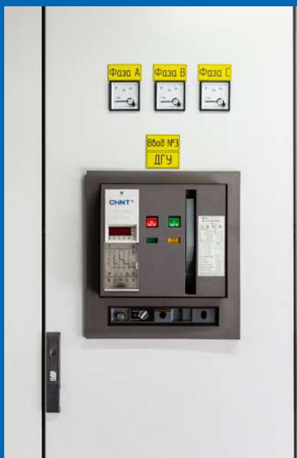
Главный распределительный щит ООО «Автоматика водоснабжения»
