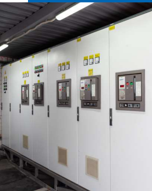
Главный распределительный щит ООО «Автоматика водоснабжения»
