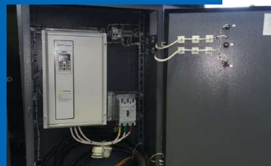
Насосная станция г. Тайшет
