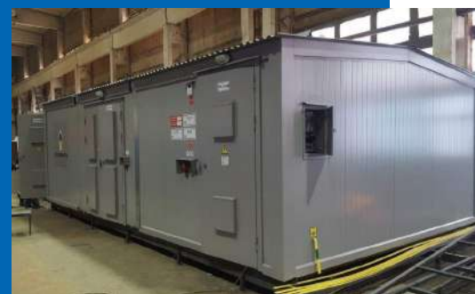
КТП в блок-модуле Компания ООО «Электрооптима» г. Казань
