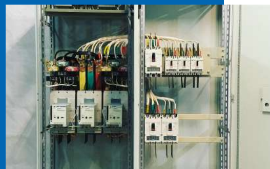
“Ачинский Котельный Завод”, ГРЩ с АВР 1250А на два ввода с секционным выключателем Компания ООО «Бонпет»
