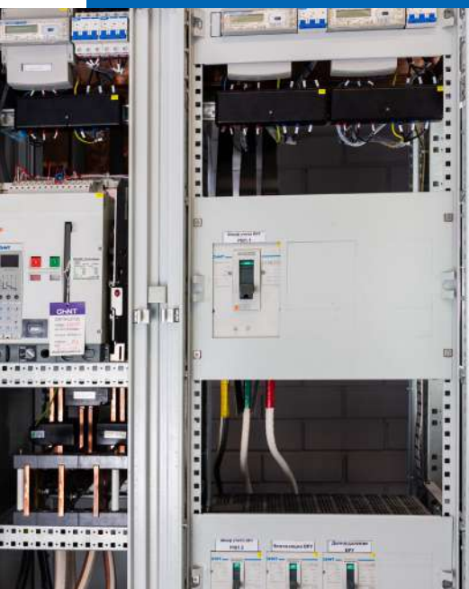
Вводное распределительное устройство ООО «Автоматика водоснабжения»
