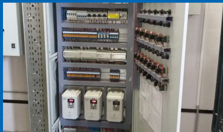
Система управления насосами повышения давления. ООО "ЭТК «Бортек»
