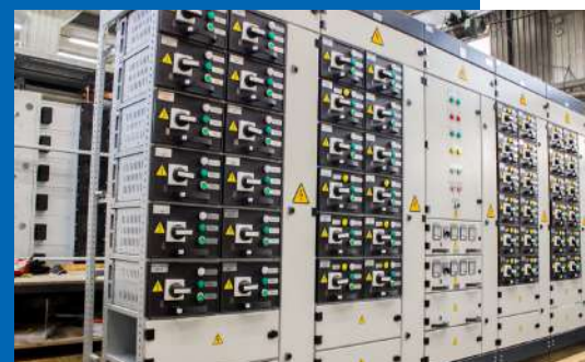
Щит управления задвижками. Компания ООО Промэлектросервис
