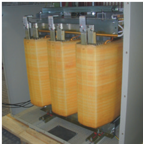
400 кВА с алюминиевыми обмотками
